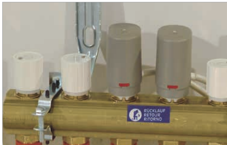
Рисунок 9. Электротермические сервоприводы, установленные на коллектор.
