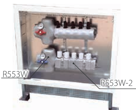
Рисунок 19. Установленный в шкаф коллектор с теплоизолирующими оболочками.
