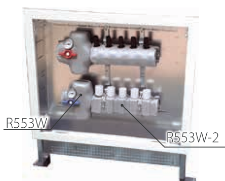
Рисунок 19. Установленный в шкаф коллектор с теплоизолирующими оболочками.
